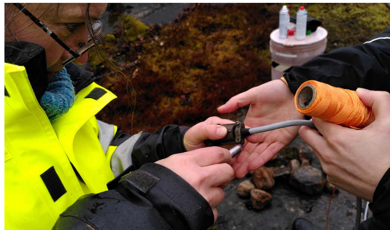
Bild 3.4: Daria Mikhaylova, forskningsingenjör, och Per Danielsson, forskningsingenjör, på fältarbete under installationen av en ny magnetometer.
